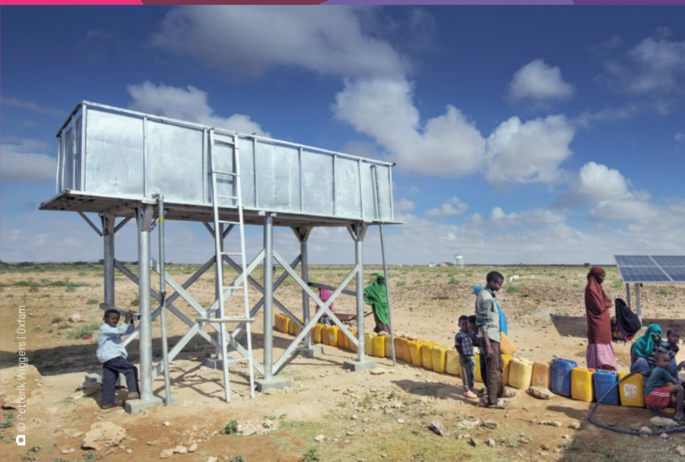
Eine der von Oxfam installierten solarbetriebenen Entsalzungsanlagen in Ceel Midgaan in Somaliland.
